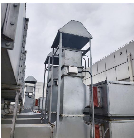
消毒风机排气口
