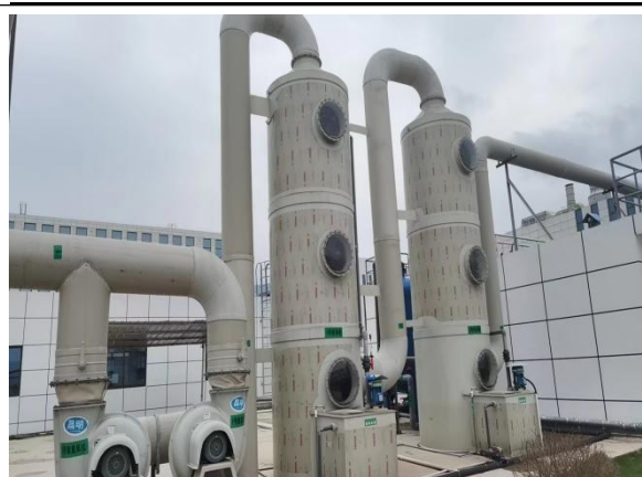
污水处理站废气治理设施
