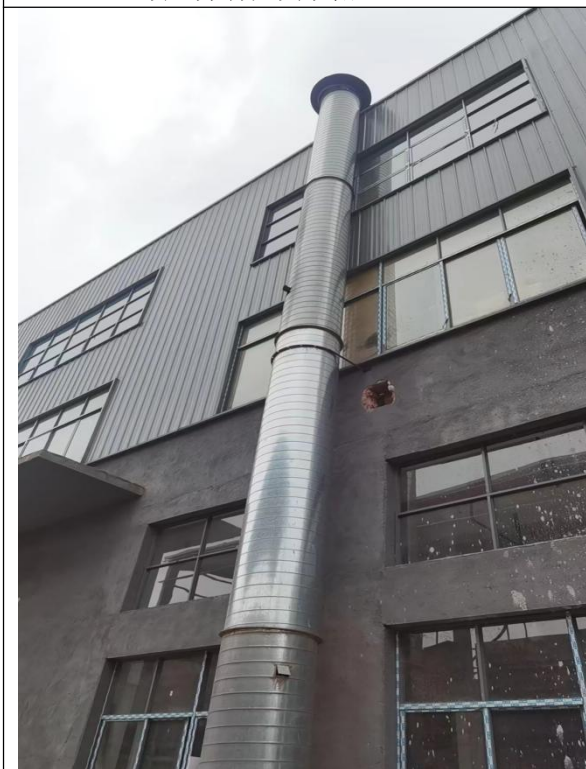
7号厂房有机废气排气筒1 (DA001)
