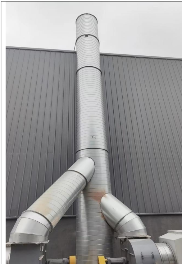
6号厂房有机废气排气筒1 (DA003)
