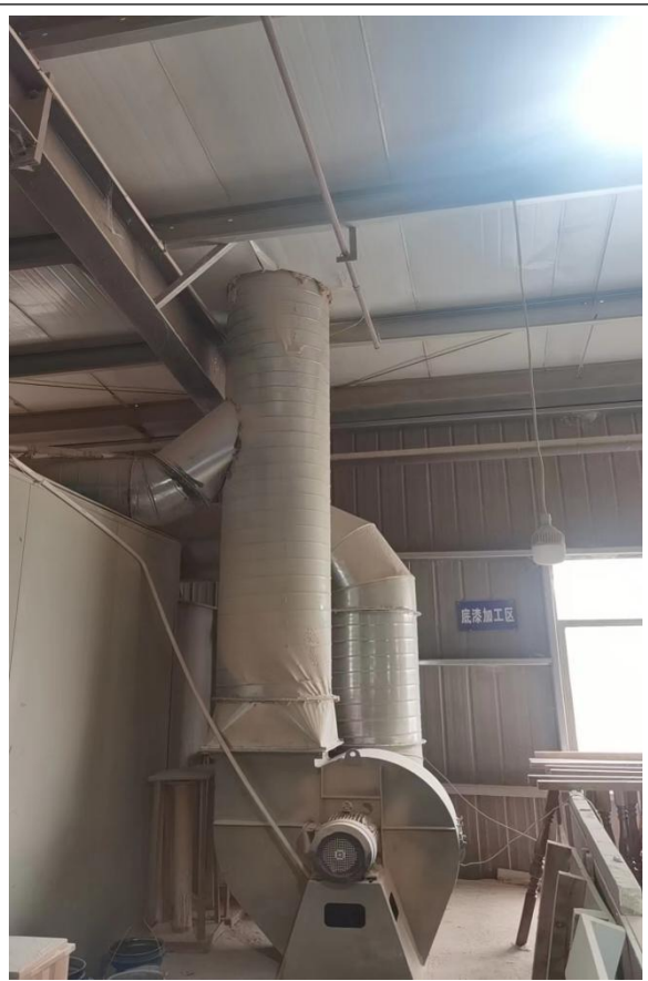
1号厂房有机废气排气筒 (DA008)
