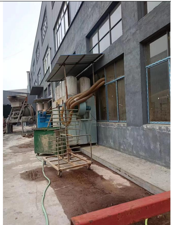
6、7号厂房一楼布袋除尘器2 (TA025)
