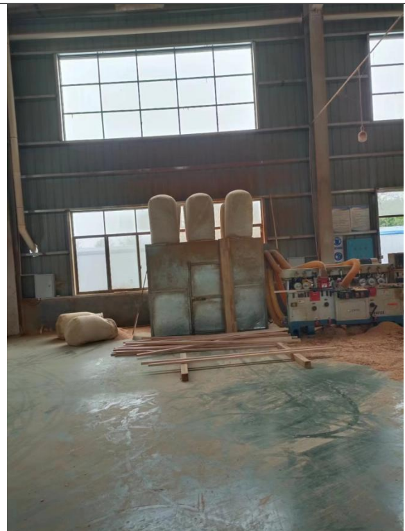
7号厂房布袋除尘器8 (TA023)
