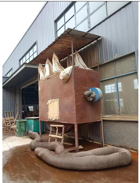
7号厂房布袋除尘器4 (TA019)
