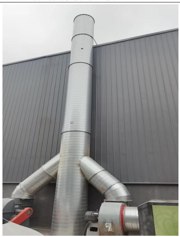
7号厂房有机废气排气筒2 (DA002)
