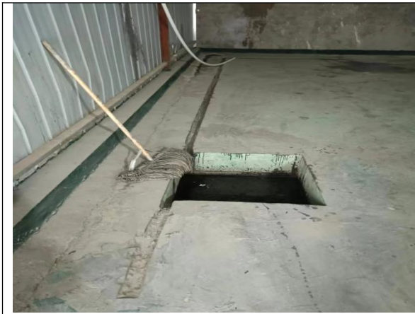
危废暂存间集液池
