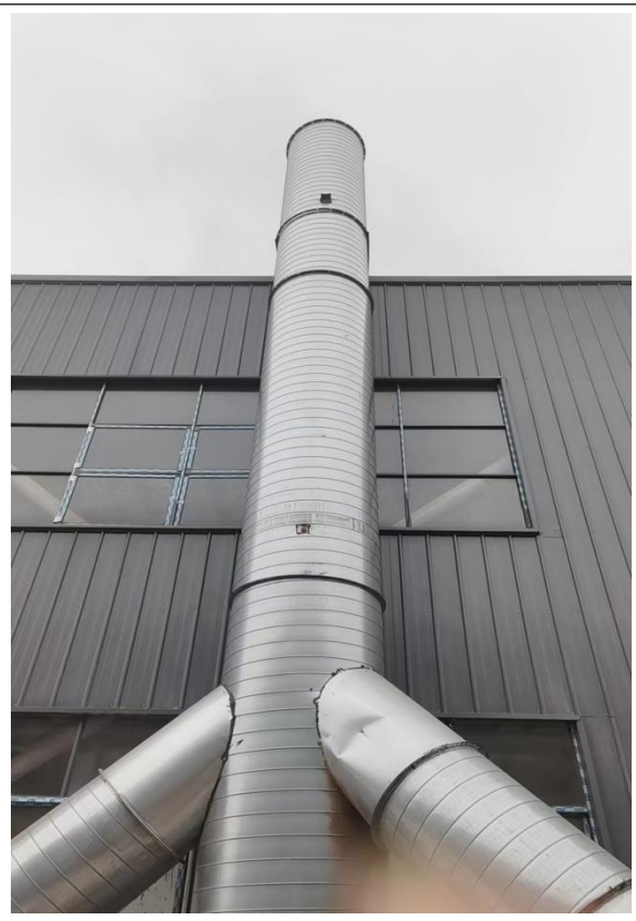
6号厂房有机废气排气筒2 (DA004)
