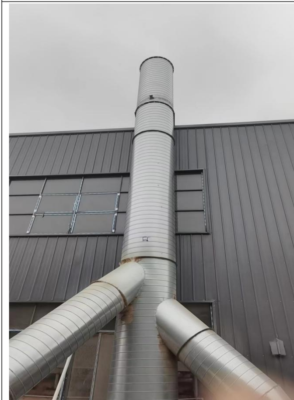
6号厂房有机废气排气筒3 (DA005)
