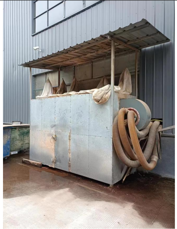
7号厂房布袋除尘器2 (TA017)
