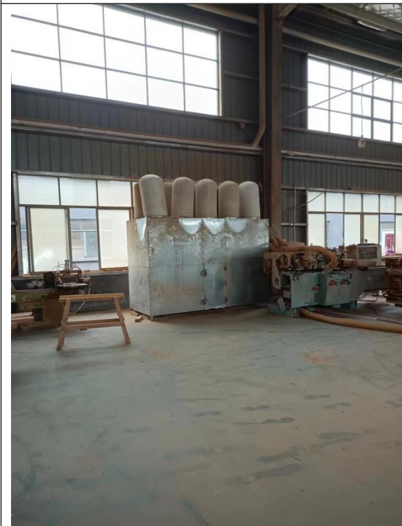
7号厂房布袋除尘器7 (TA022)
