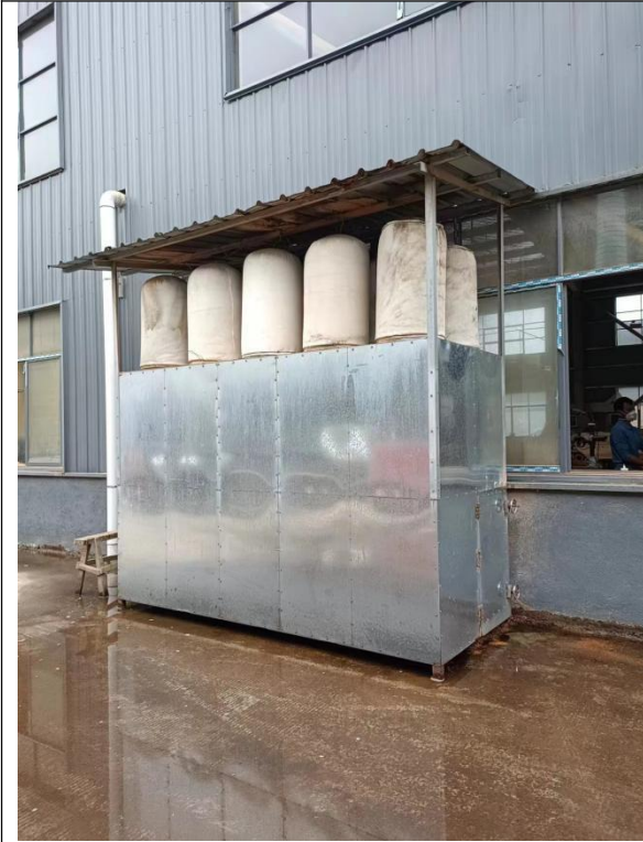
7号厂房布袋除尘器1 (TA016)
