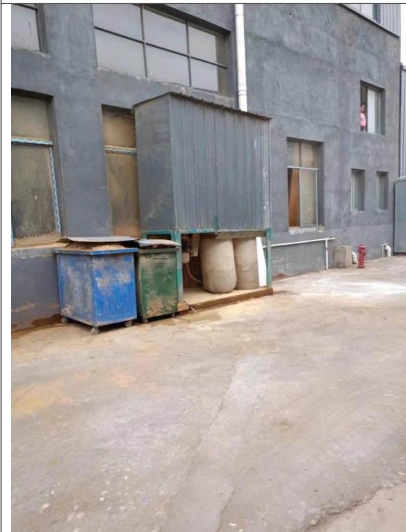
6、7号厂房一楼布袋除尘器3 (TA026)
