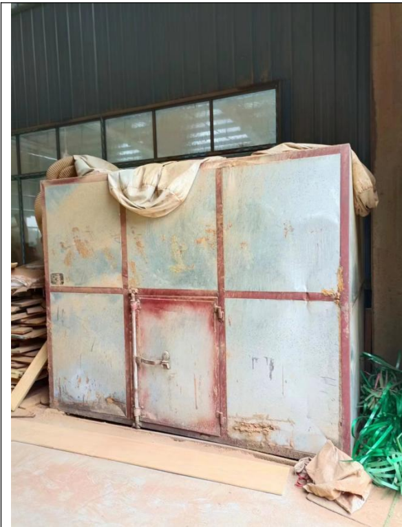
7号厂房布袋除尘器5 (TA020)
