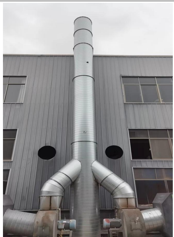
5号厂房有机废气排气筒1 (DA006)
