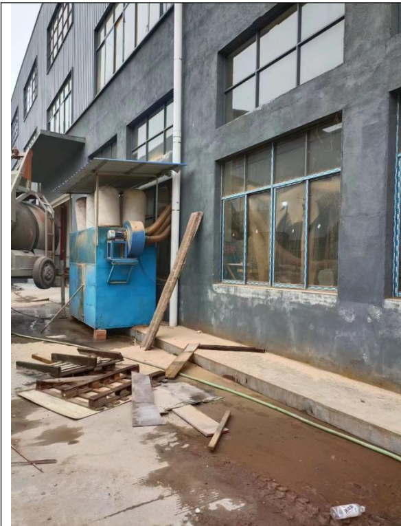
6、7号厂房一楼布袋除尘器1 (TA024)
