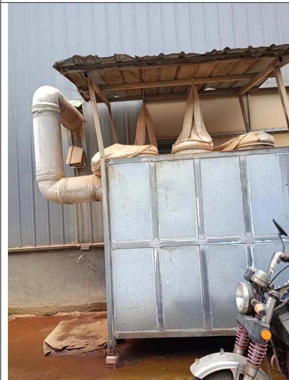
7号厂房布袋除尘器3 (TA018)
