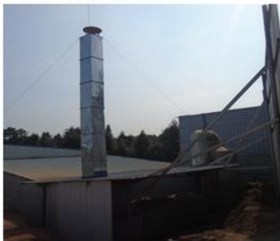
油漆车间废气排气筒
