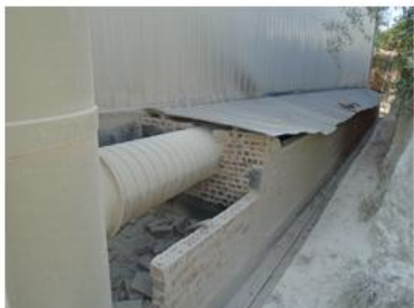
底漆车间废气收集管道
